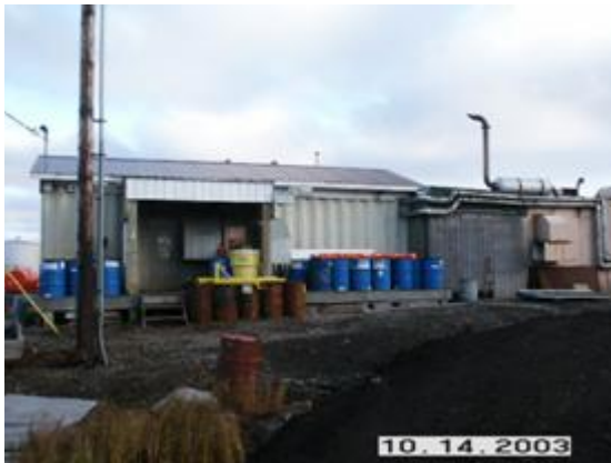
Figure 9: AVEC power plant in Savoonga
